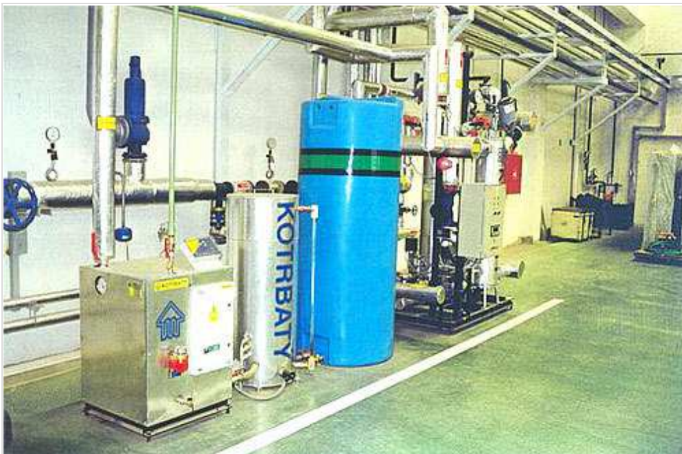
Obr. 7 Expanzní zařízení s doplňováním ve výměňkové stanici
