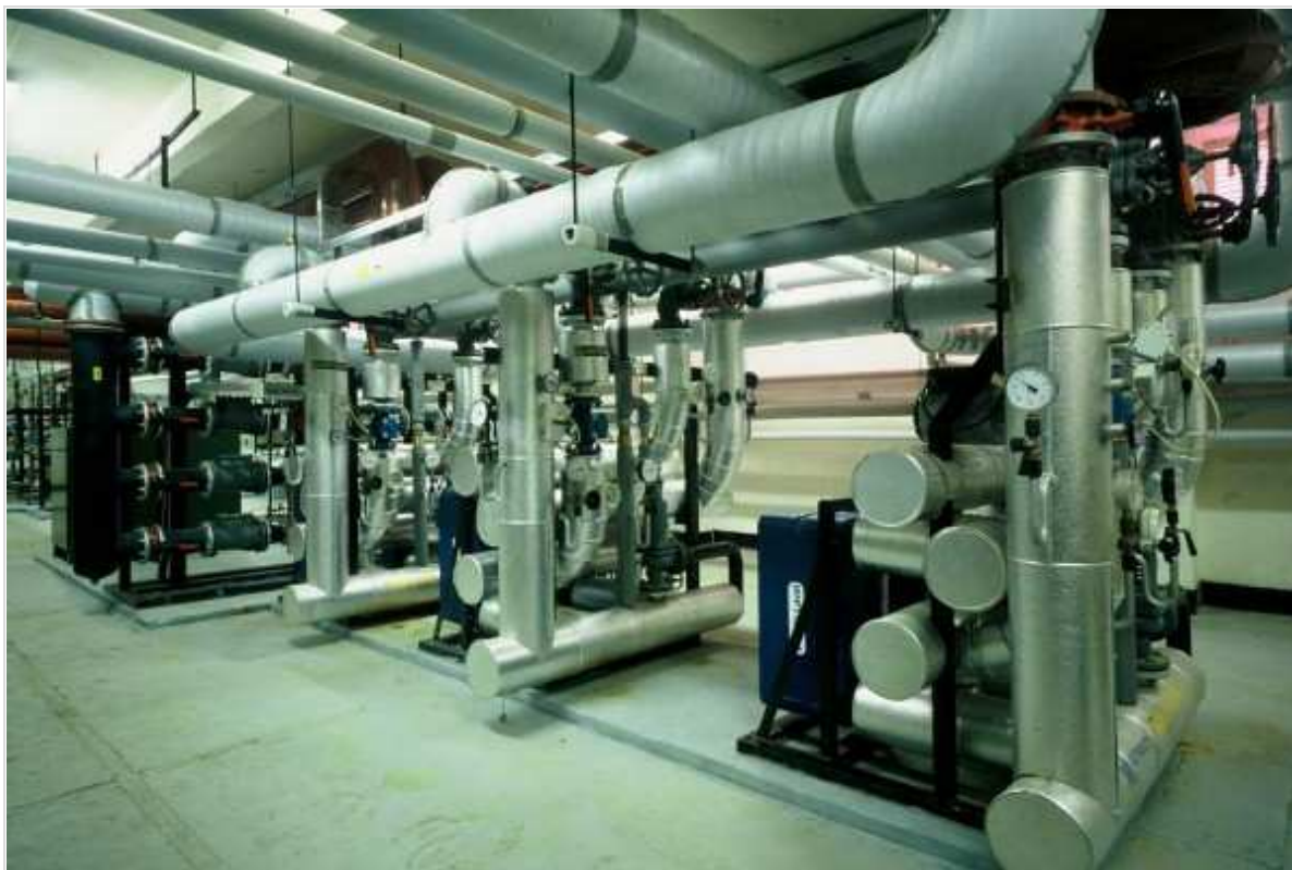
Obr. 1 Blokovaná výměňková stanice voda - voda
